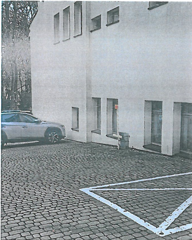
Widok parkingu od strony zalewanej ściany piwnicznej (brak przeciw spadków od str budynku)
